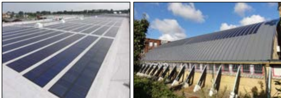
Figure 3 : Centrales photovoltaïques utilisant des cellules amorphes (source : Cohérence Energies)
