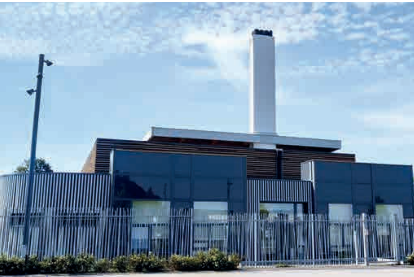
Chaudière biomasse de l'écoquartier du Raquet
